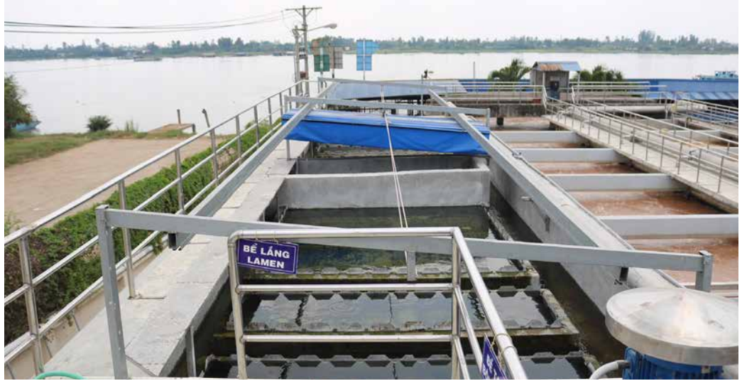
Hệ thống xử lý nước thải
